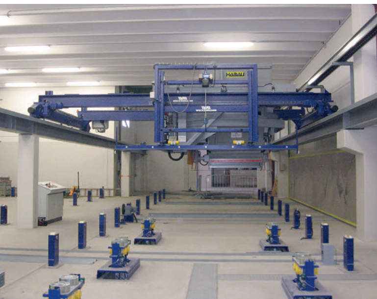
Station de compactage MagVib – application dans une nouvelle usine
